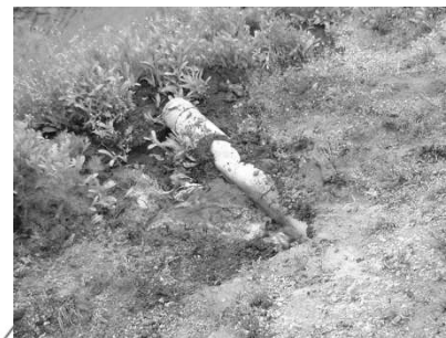
写真2 旧暗渠からの漏水
